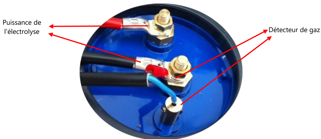
Fig 5 – Bornes de connexion de cellule d'électrolyse
